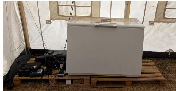
Abbildung 4: Anschluss an die Powerstation
